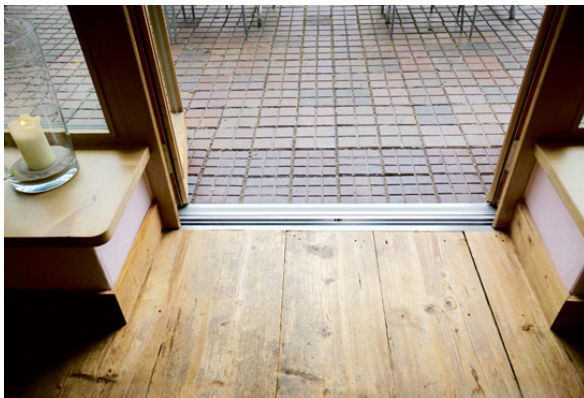
Diese Nullschwelle wurde 2011 in einer zweiflügeligen Fenstertür verbaut und hält seitdem systemsicher und zuverlässig jedes Wetter draußen - auch ohne zusätzliche Rinne oder größeres Vordach.
