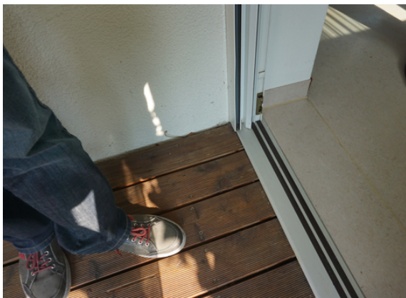
Die Nullschwellen-Forderungen der Norm für barrierefreies Bauen sind mit der baukonstruktiven Machbarkeit gekoppelt. Außentürdichtungen ohne Türanschlagdichtungen wurden bereits 1996 selbst für Fenstertüren mit Magnet-Dichtungen technisch gelöst. Diese Magnet-Nullschwelle wurde bereits 1999 im Betreuten Wohnen eingebaut und zeigt seither zuverlässige Funktionstauglichkeit und Dichtheit.
